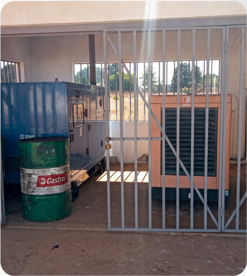
Avimuíla – Estrutura para gerador – Quipungo
