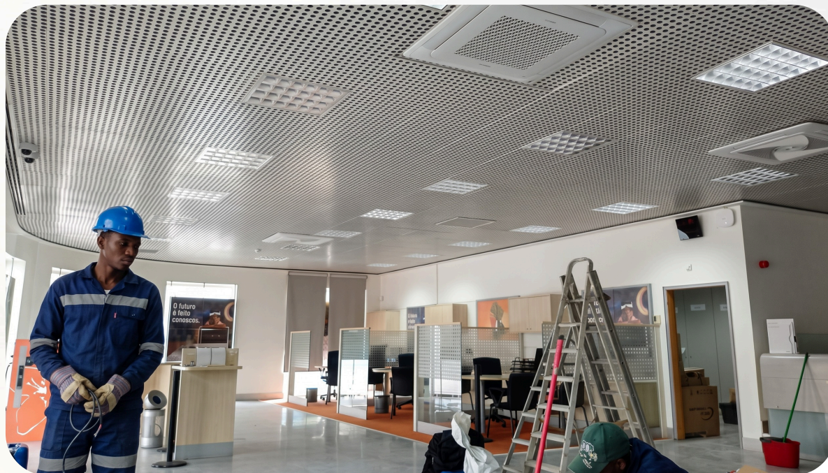
BFA - Redes técnicas de electricidade, dados e segurança - Lubango
